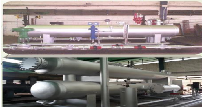
EQUIPO PARA PRUEBA DE POZOS (WELL TESTING)
